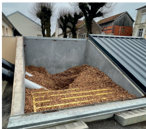
Réseau de chaleur - Silo - Entrains-sur-Nohain
